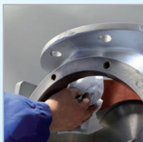
10. Rengjør huset innvendig, husk innløpet
