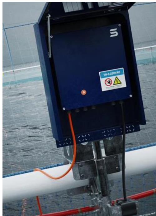
Figur 2: Kontrollskap med beskyttelsesskap
