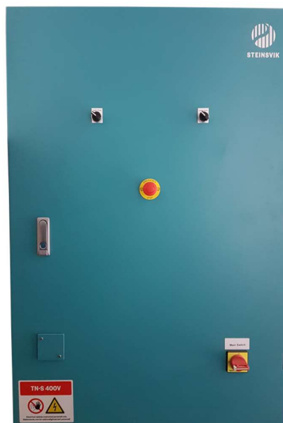
Bilde 27 Elektrisk styreskap
